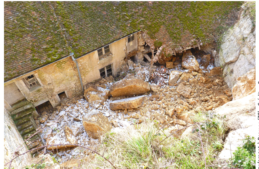
Eboulement à Pesmes (70) - Crédits : Cerema
